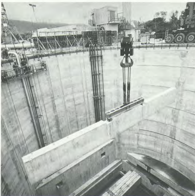
Vue du puits d'accès de 23 m de diamètre et de 54 m de profondeur pendant la phase de préparation des infrastructures.
